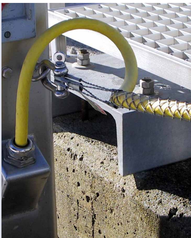
STATION D'ÉPURATION ARA
