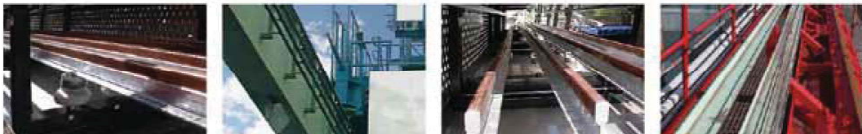
Offene Schleifleitungs-Systeme in der Anwendung
