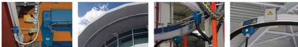
SCL Schleifleitungs-Systeme in der Anwendung
