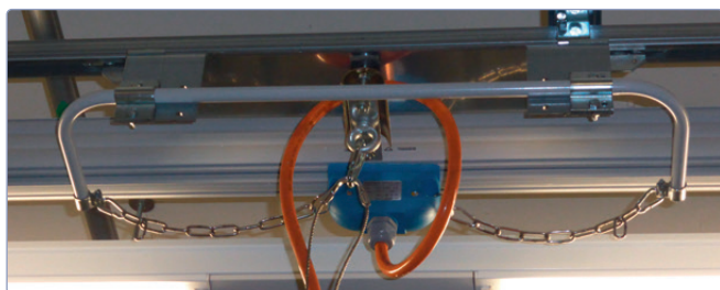
Stinger-System, Schleifleitung in Kombination mit Kabelwagenanlage, C-Profilsschiene kann Zug aufnehmen
