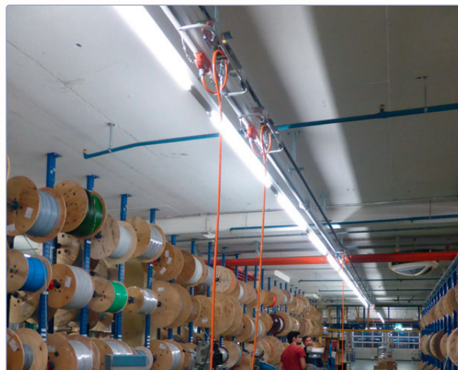
Stinger-System, Schleifleitung in Kombination mit Kabelwagenanlage für Kabelabläng-Maschinen
