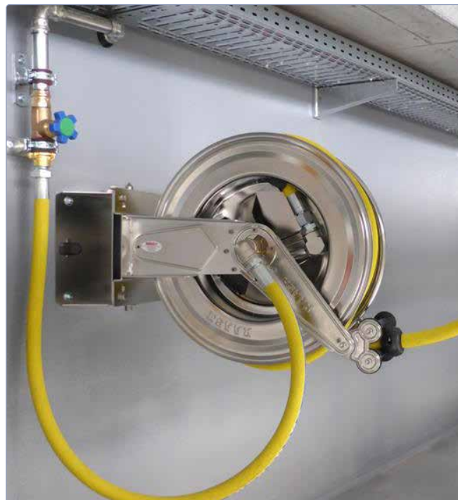
Enrouleur de tuyau en inox, pivotant pour l'eau potable
